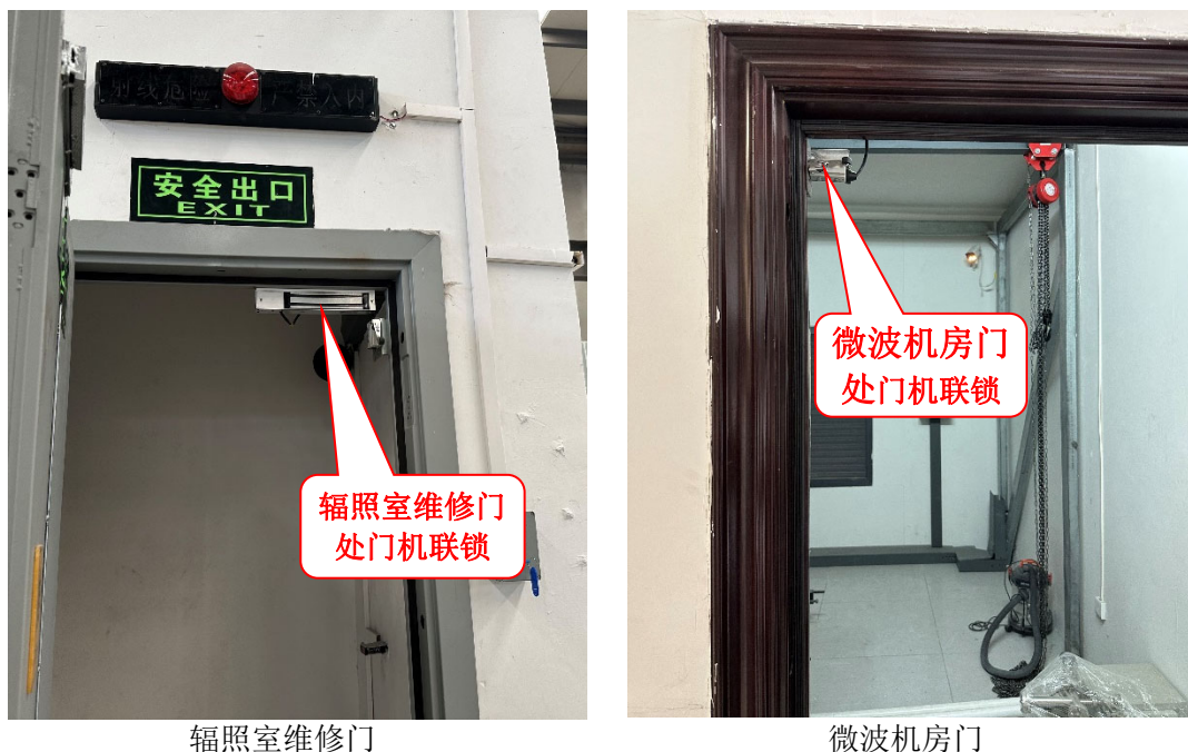
图 3-3 辐照室维修门、微波机房门处门机联锁装置
