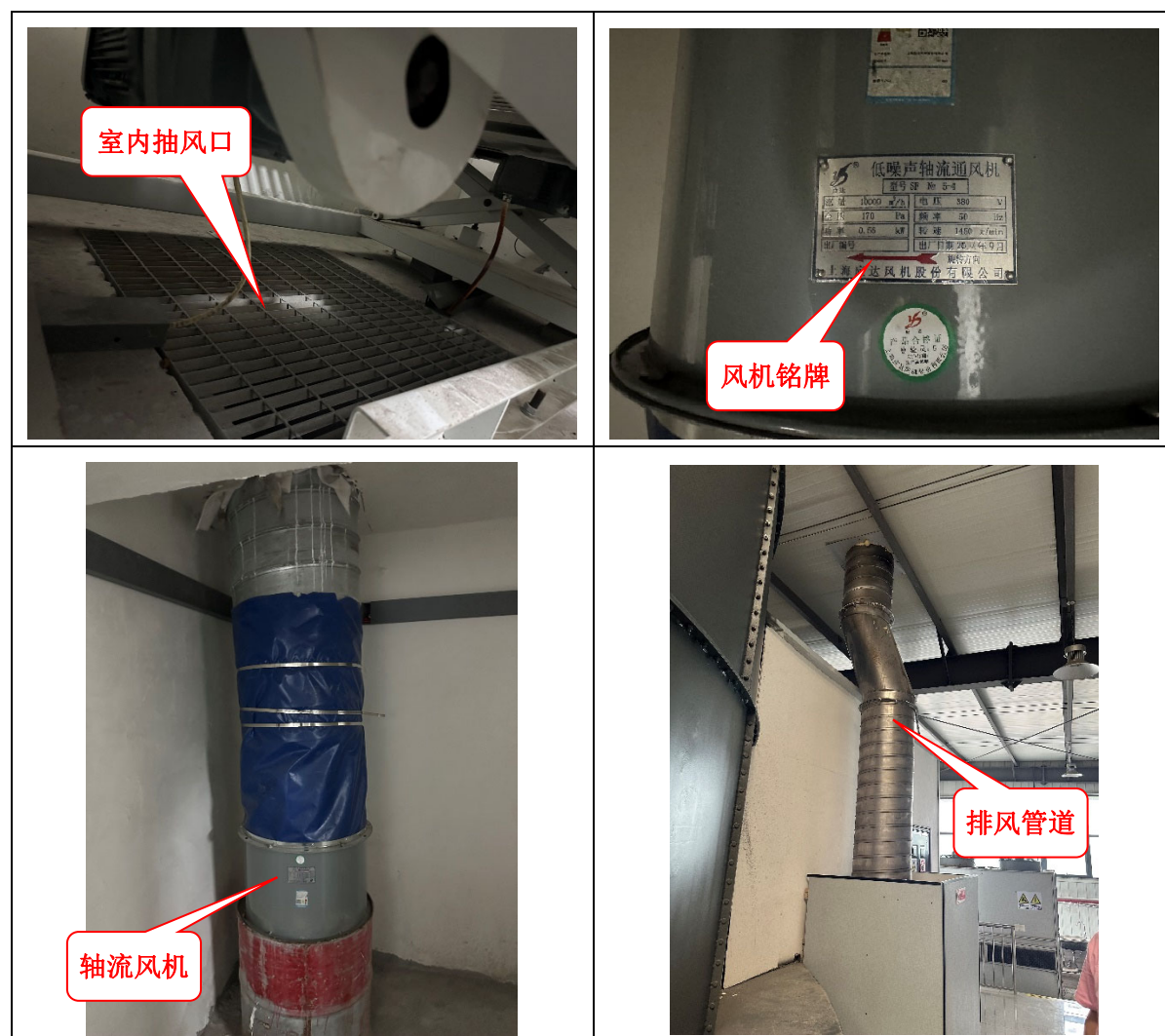
图 3-17 辐照加速器机房排风装置
