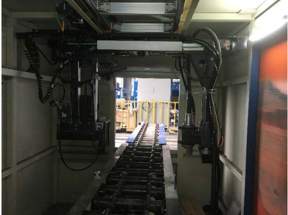
3 号探伤铅房内部图
