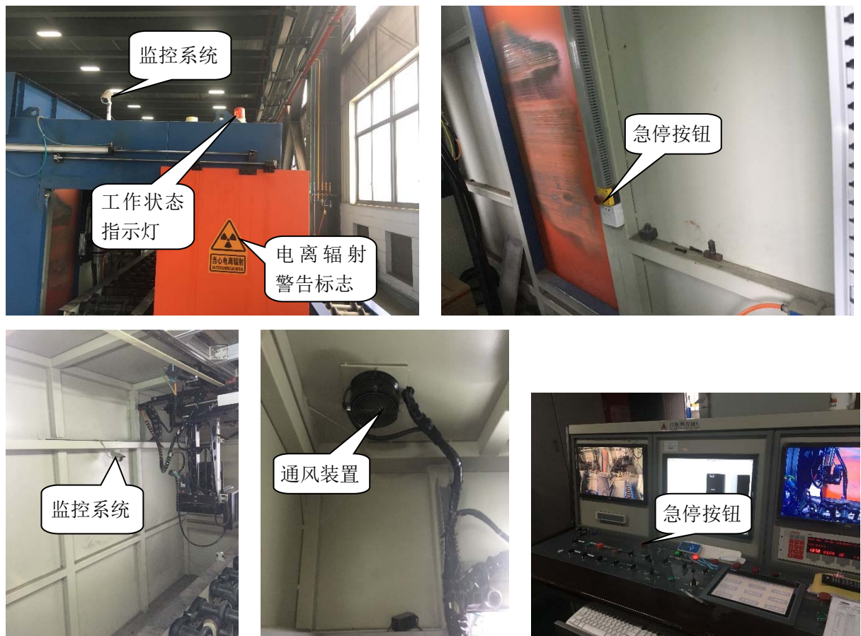
图 10-2 本项目拟搬迁的 3 号探伤铅房现有的安全措施
