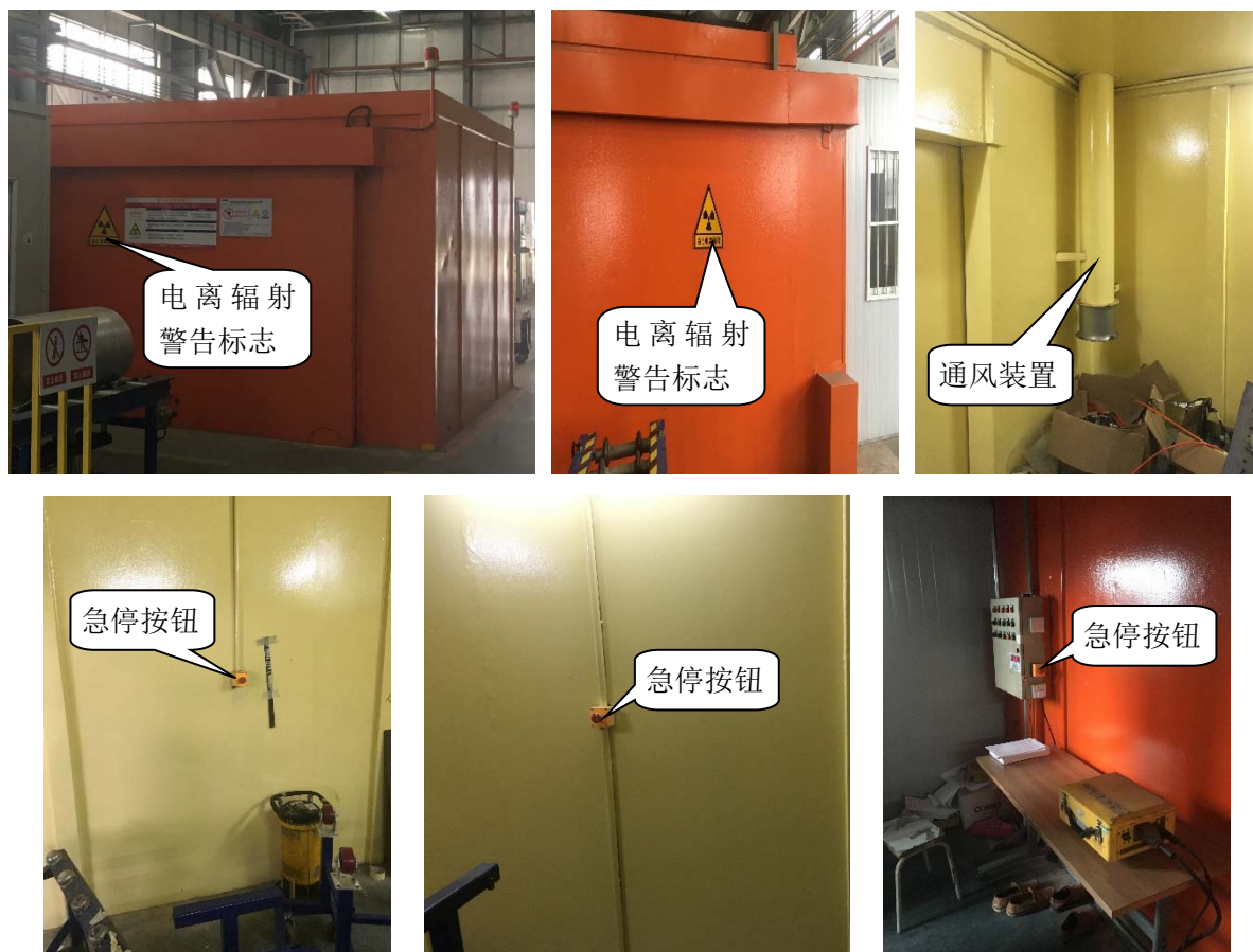
图 10-3 本项目拟搬迁的 4 号探伤铅房现有的辐射安全措施
