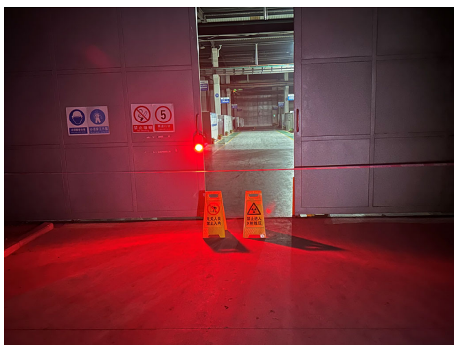
控制区边界处电离辐射警告标志、声光报警装置、警告牌及警戒线等
