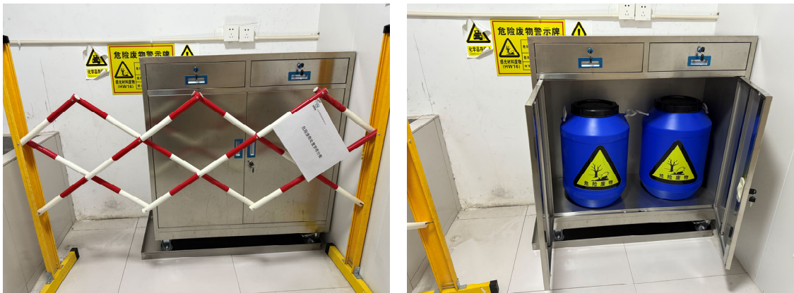
图 3-4 危废储存柜现场图
