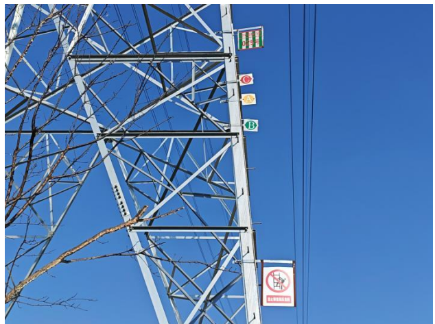
220kV 肖真 4H15/4H16 线 25#杆塔 警示和防护指示标志
