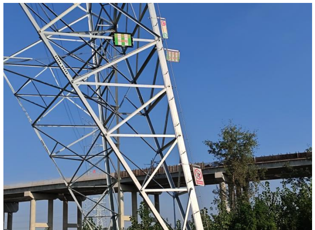
220kV 肖真 4H15/4H16 线 26#杆塔 警示和防护指示标志
