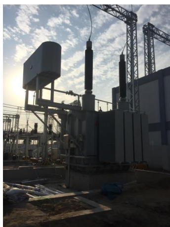
变电所主变压器
