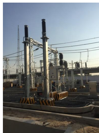
变电所低压侧
